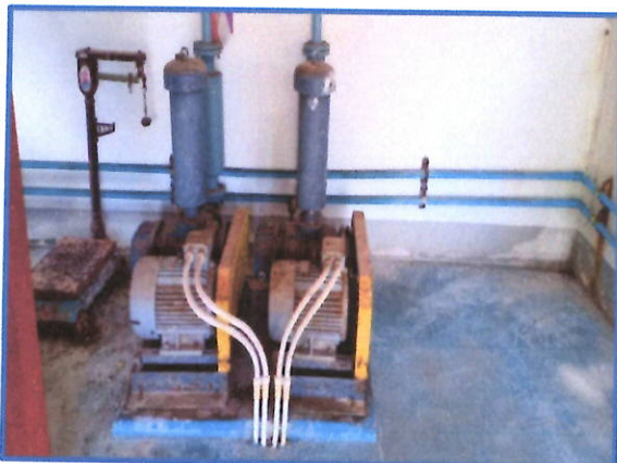
อาคารผลิตน้ำ (เครื่องเป่าลม)
