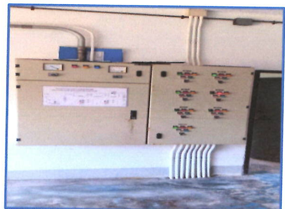
อาคารผลิตน้ำ (ตู้ควบคุมระบบจ่ายสารเคมี)
