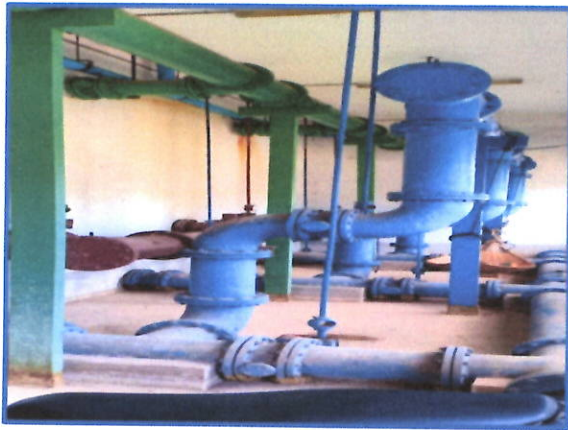
อาคารผลิตน้ำ (ท่อและอุปกรณ์)
